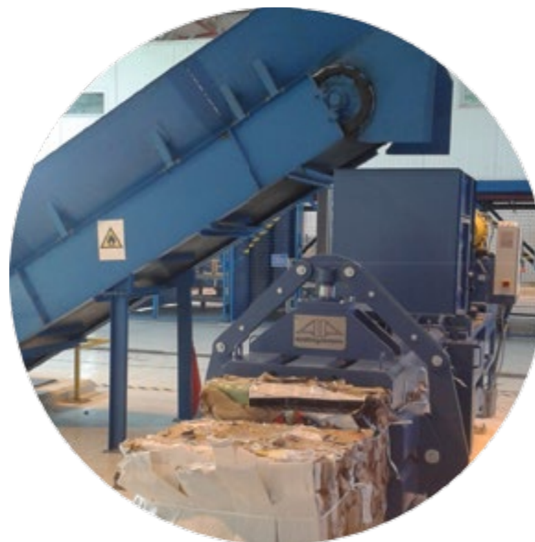
На установке сегрегации отходов Экоцентра
